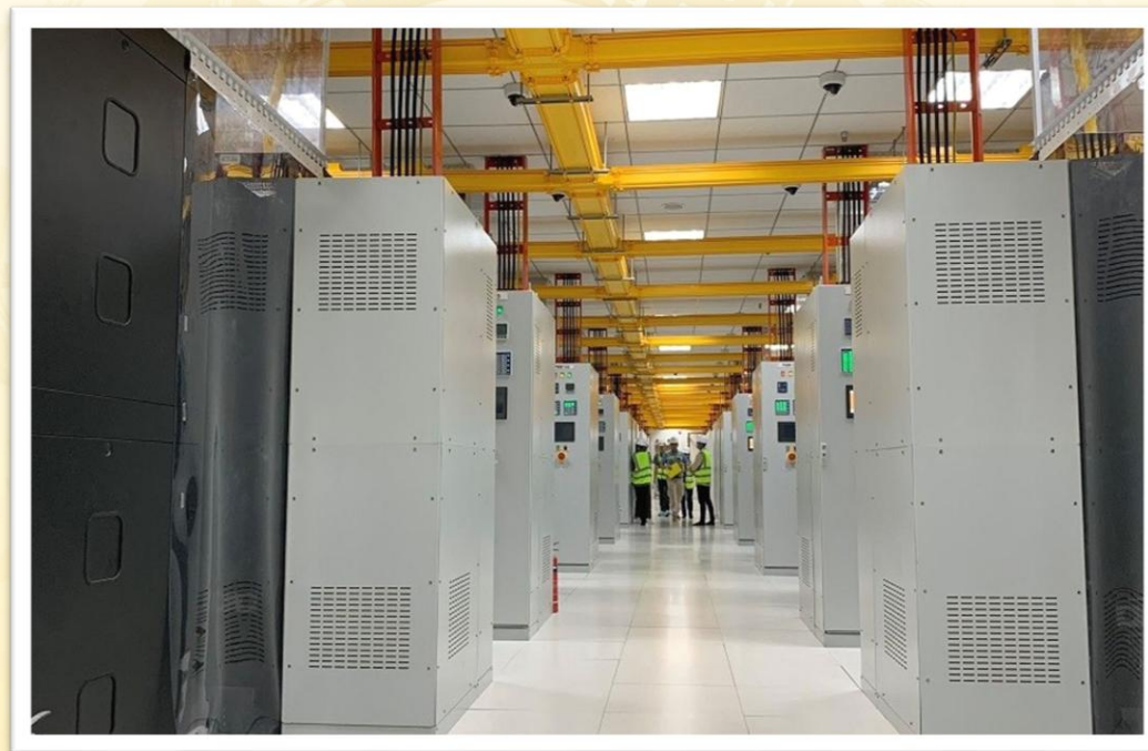
Hệ thống thiết bị được lắp đặt theo tiêu chuẩn quốc tế. Nguồn từ Internet.
